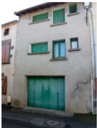
fissure et «salpêtre», symptômes de désordres sur un enduit ciment
