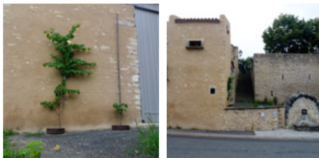
l'enduit à pierre «mi vue» évoque les enduits érodés ... la juxtaposition de surfaces enduites et jointoyées anime le bâti
