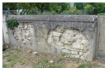
méfais de l'enduit ciment et de son incompatibilité avec la pierre. L'enduit, imperméable, empêche l'évaporation de l'eau absorbée par le mur. Sous l'ef- fet du gel ou de l'usure, il se dé- colle par plaques ... en entraî- nant la surface des pierres
