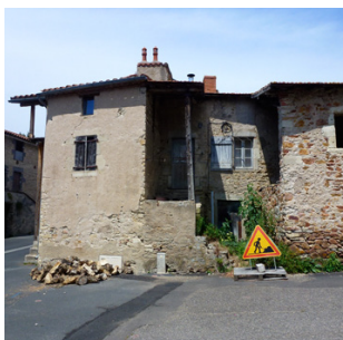
les enduits érodés laissent en- trevoir les maçonneries
